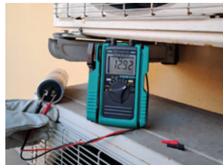
Figura 6. Na manutenção de um ar condicionado, podemos medir condensadores ou díodos.
